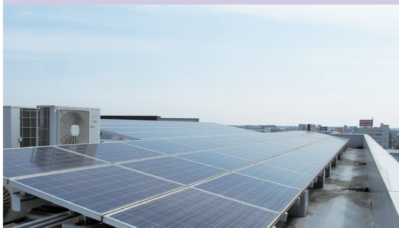
災害時に灯りがとれるように太陽光パネルが設置されている セレモニア富士 50号バイパス館 (㈱エディファミリー本社) 屋上
