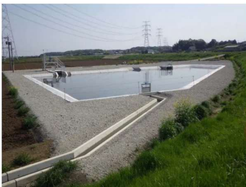
大宝沼2期地区 第4用水機場
