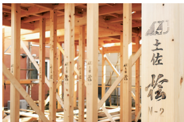
土佐桧を使った住宅の新築工事の様子(写真提供：日栄商事)
